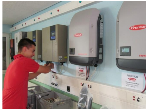
Die Wechselrichter für die PV-Anlage
