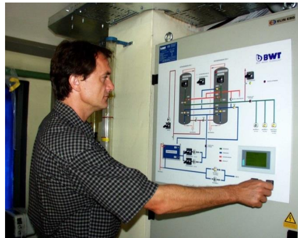
Die Regelungsanlage (Wasser)
