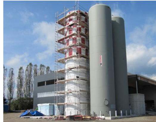
Fernwärmeversorgung mit innovativem Lastmanagement © Einreicher
