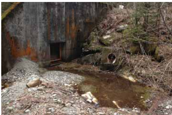
*2. Überprüfung: an dieser Wasserfassung wurde kein Restwasser abgegeben
