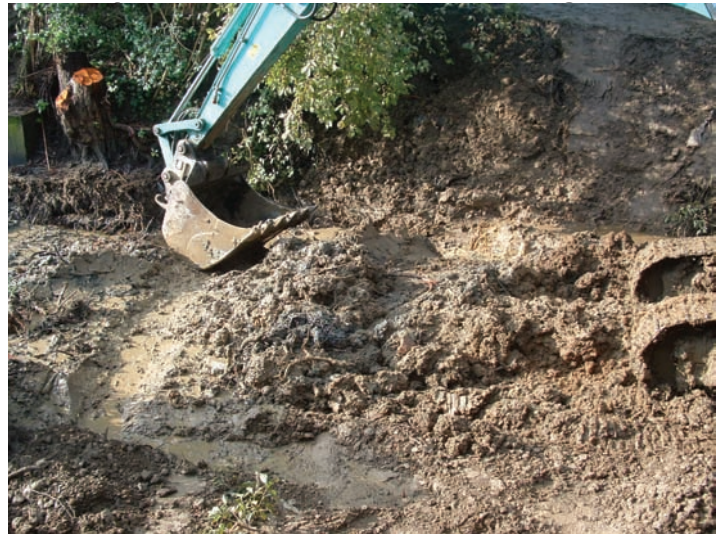
© O. Tiefenbach: massive Eingriffe in die Bachsohle
